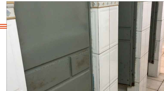
FIGURA 83: PUERTA CON OXIDO
