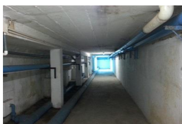
Figura 36: Cuarto de bomba piscina Vallarino
