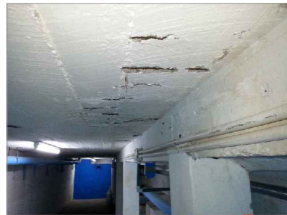
FIGURA 34: HUMEDAD EN LOSA DESPRENDIMIENTO DE HORMIGÓN
