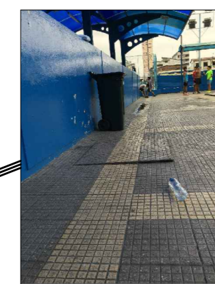
FIGURA 53: CORREGIR NIVEL DE TAPA DE CAJA DE REGISTRO
