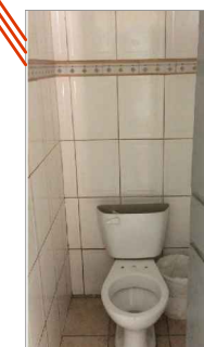
FIGURA 84: INODOROS SIN TAPA DE TANQUE DESAGÜE TAPADO INODORO CON FUGA DE AGUA
