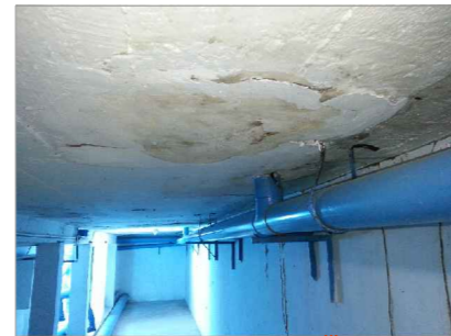
FIGURA 35: HUMEDAD EN LOSA
