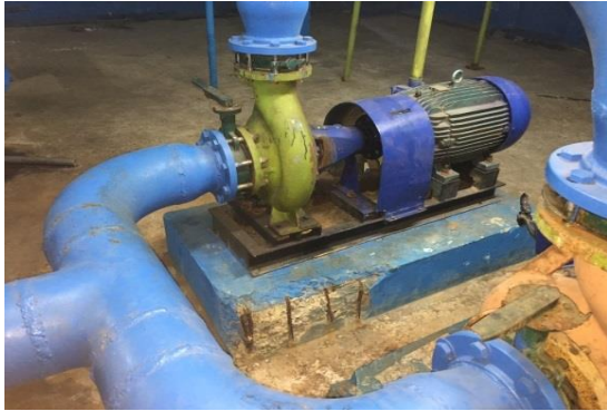
Figura 75: Cuarto de bomba piscina Asisclo Garay
