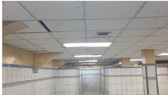
FIGURA 79: HUMEDAD EN PAREDES
