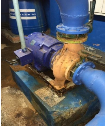
Figura 76: Cuarto de bomba piscina Asisclo Garay
