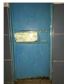
FIGURA 86: CAMBIO PANEL INFERIOR ÓXIDO Y CORROSIÓN
