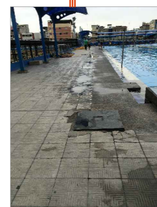
FIGURA 69: CORREGIR LAS PENDIENTES DEL PISO POR ACUMULACIÓN DE AGUA
