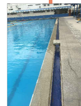
FIGURA 68: GRANITO DE PIEDRA LAVADA CON FISURAS
