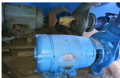
Figura 27: Cuarto de bomba piscina Vallarino
