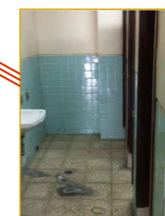
FIGURA 96: PUERTAS DE MADERA CON POLILLAS
