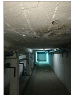
FIGURA 36: HUMEDAD EN LOSA
