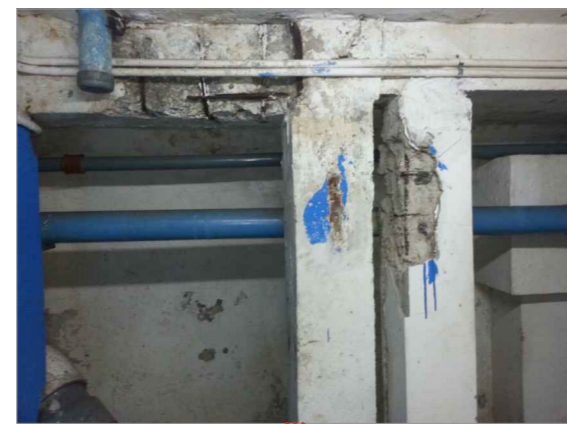
FIGURA 26: DESPRENDIMIENTO DE HORMIGÓN EN VIGA Y COLUMNAS
