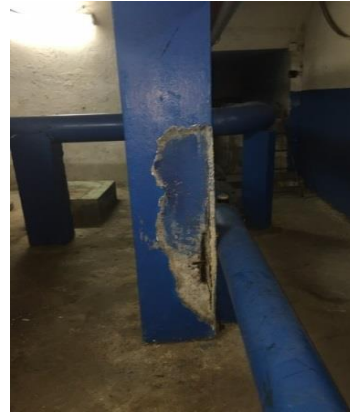
Figura 72: Cuarto de bomba piscina Asisclo Garay
