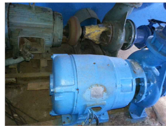
FIGURA 27: BOMBAS DE 40 HP
