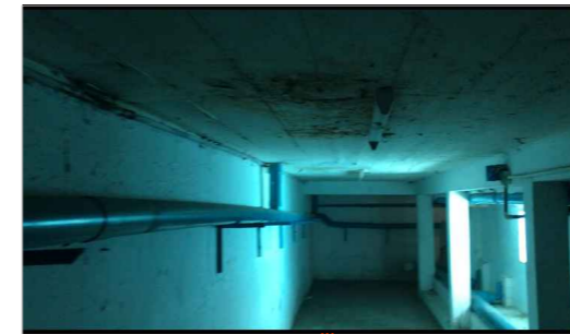
FIGURA 37: HUMEDAD EN LOSA
