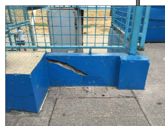
FIGURA 56: TABIQUE EN MAL ESTADO, DESPRENDIMIENTO DE HORMIGÓN
