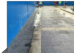
FIGURA 52: CORREGIR LAS PENDIENTES DEL PISO POR ACUMULACIÓN DE AGUA
