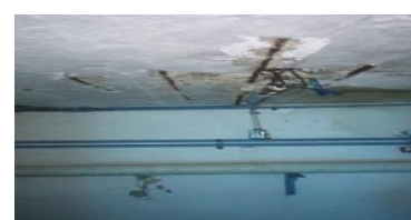
Figura 42: Cuarto de bomba piscina Vallarino
