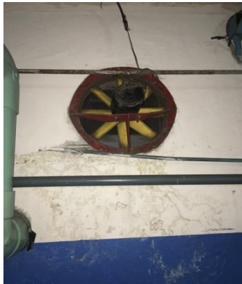
Figura 73: Cuarto de bomba piscina Asisclo Garay
