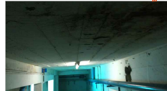
FIGURA 43: HUMEDAD EN LOSA DESPRENDIMIENTO DE HORMIGÓN
