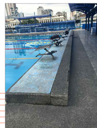
FIGURA 61: DESPRENDIMIENTO DE GRANITO
