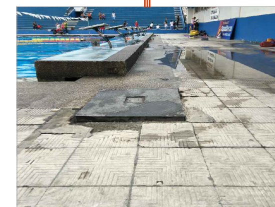
FIGURA 67: CORREGIR NIVEL DE TAPA DE CAJA DE REGISTRO
