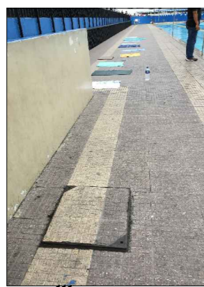
FIGURA 48: CORREGIR NIVEL DE TAPA DE CAJA DE REGISTRO
