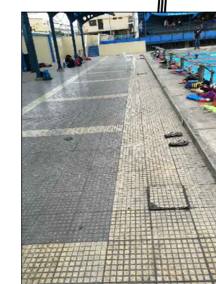
FIGURA 60: CORREGIR NIVEL DE TAPA DE CAJA DE REGISTRO
