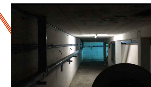
FIGURA 41: HUMEDAD EN LOSA
