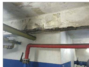
FIGURA 71: VIGA CON DESPRENDIMIENTO DE HORMIGÓN Y HIERRO CON OXIDO Y CORROSIÓN
