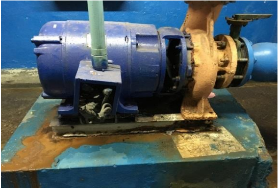
Figura 77: Cuarto de bomba piscina Asisclo Garay
