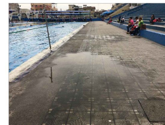
FIGURA 64: ACUMULACIÓN DE AGUA, REJILLA DE PISO TAPADA
