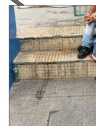
FIGURA 55: GRADAS EN MAL ESTADO
