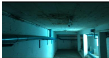
Figura 37: Cuarto de bomba piscina Vallarino
