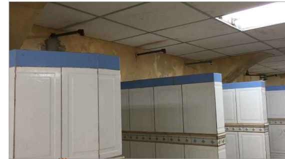
FIGURA 81: DUCHAS EN MAL ESTADO: CAMBIO DE GRIFERÍA
