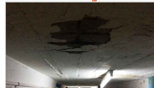
FIGURA 44: HUMEDAD EN LOSA DESPRENDIMIENTO DE HORMIGÓN
