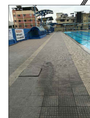
FIGURA 57: CORREGIR LAS PENDIENTES DEL PISO POR ACUMULACIÓN DE AGUA
