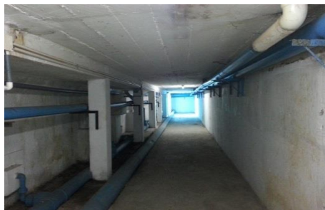
Figura 25: Cuarto de bomba piscina Vallarino
