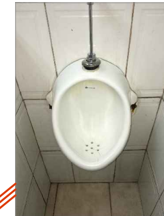
FIGURA 82: URINARIO EN MAL ESTADO (QUEBRADO)
