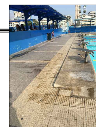
FIGURA 54: CORREGIR LAS PENDIENTES PISO POR ACUMULACIÓN DE AGUA
