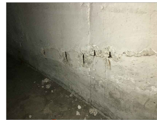
FIGURA 28: DESPRENDIMIENTO DE HORMIGÓN EN PARED (3m X 1,20m)
