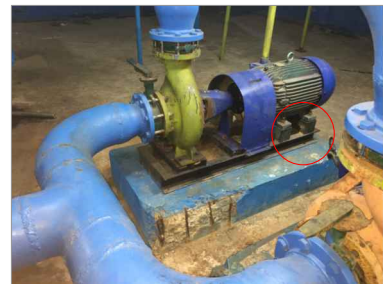
FIGURA 75: DESPRENDIMIENTO DE HORMIGÓN HIERRO EXPUESTO A LA HUMEDAD
