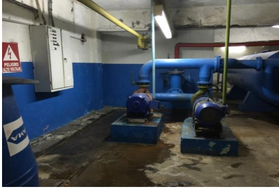
Figura 78: Cuarto de bomba piscina Asisclo Garay
