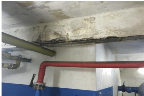
Figura 71: Cuarto de bomba piscina Asisclo Garay
