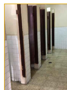
FIGURA 98: PUERTAS DE MADERA CON POLILLAS
