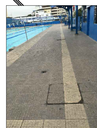
FIGURA 59: CORREGIR NIVEL DE TAPA DE CAJA DE REGISTRO
