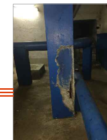
FIGURA 72: DESPRENDIMIENTO DE HORMIGÓN Y HIERRO CON OXIDO Y CORROSIÓN
