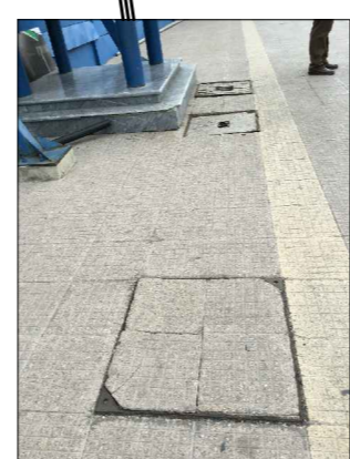
FIGURA 58: TAPA DE CÁMARAS DE HORMIGÓN DESTRUÍDAS
