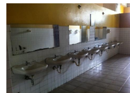
Figura 18: vista de lavamanos en el baño para deportistas Fuente: elaboración propia
