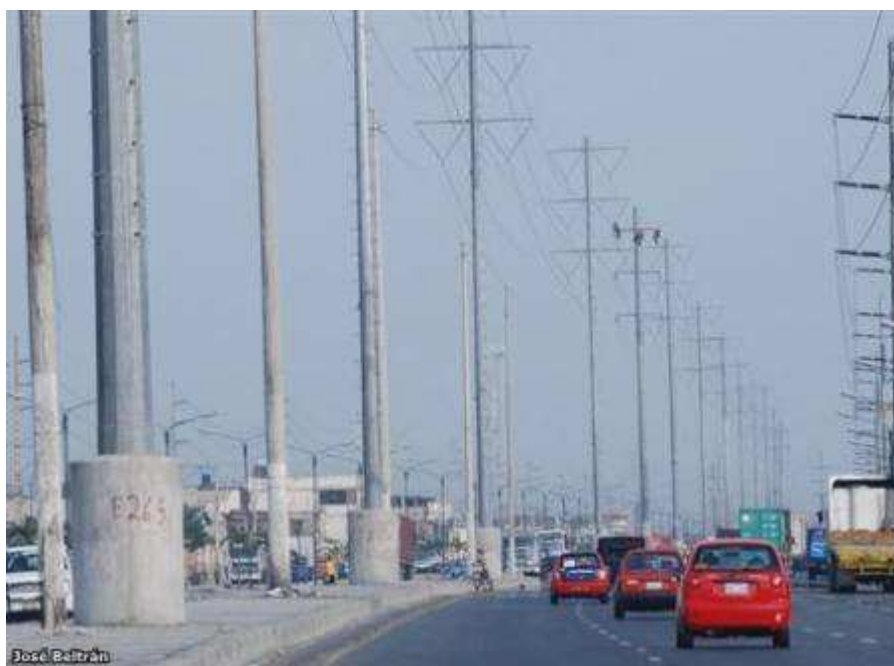
Fig.9 Líneas de transmisión
