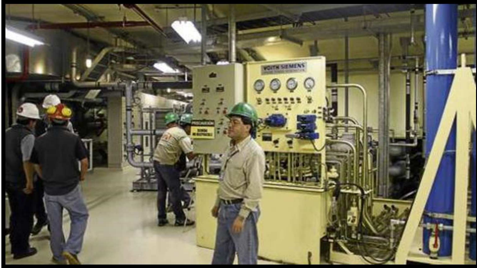
Fig. 1. Cuarto de máquinas, hidroeléctrica de Paute
