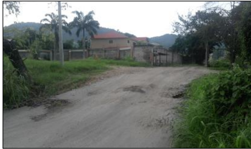
Figura 5.3 Vía de acceso no cuenta con pavimentación
