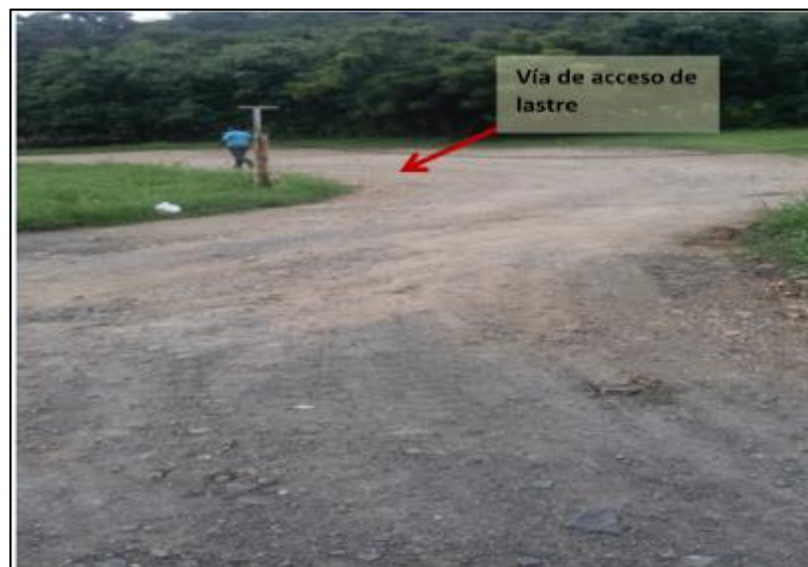
Figura 5.2 Vía de acceso no cuenta con pavimentación
