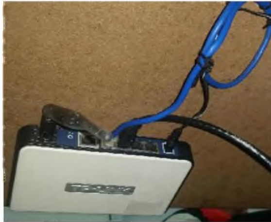
Figura 3. 34: Equipo TP-LINK ubicado en el laboratorio de telecomunicaciones Fuente: (García Gamboa, 2015)
