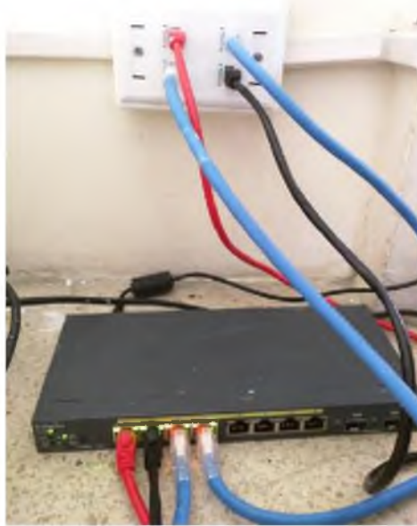
Figura 4. 6: Caja sobrepuesta de 4 puertos con switch POE Engenius
