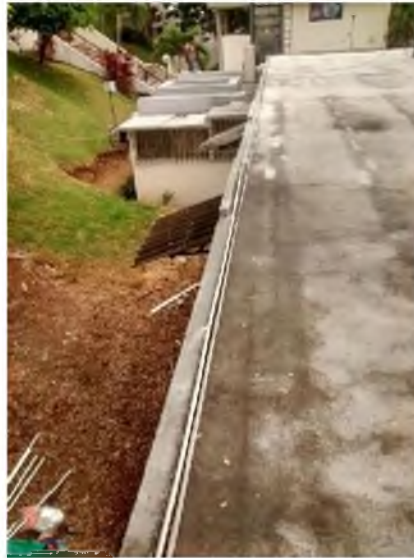
Figura 4. 4: Paso de tubería por el bloque administrativo
