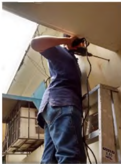
Figura 4. 8: Creación de orificio para el paso de cables fuera del laboratorio de electrónica
