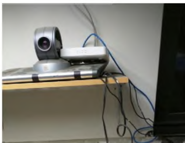
Figura 4. 18: Punto de acceso ubicado en la Sala de Profesores
