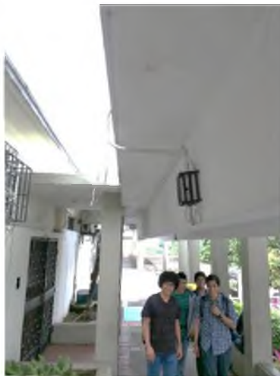
Figura 4. 12: Tubería para el punto de datos fuera del aula virtual
