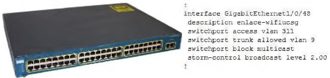
Figura 3. 11: Switch Cisco Catalyst 2950 y configuración del puerto 48 Fuente: (Almacen Informatico, 2009)
