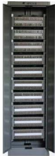
Figura 2. 15: ODF. Fuente: (HUAWEI, 2015)
