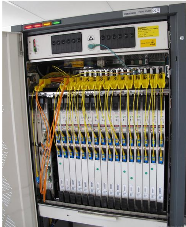
Figura 2. 12: OLT. Fuente: (HUAWEI, 2015)
