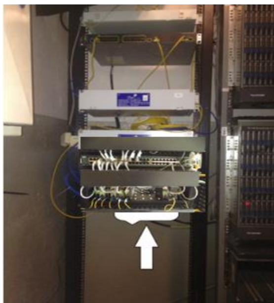
Figura 3. 22: Rack Ubicado dentro de las instalaciones del Banco Bolivariano donde se ubica el switch desde el cual se realiza la transmisión de datos del enlace de radio.
