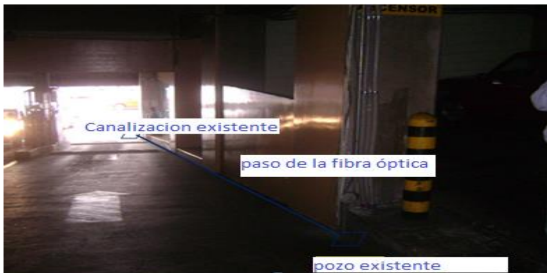
Figura 3. 21: Ingreso de la Fibra óptica hacia las instalaciones de la Agencia en las cuales se encuentran las canalizaciones por donde debe pasar la fibra óptica.
