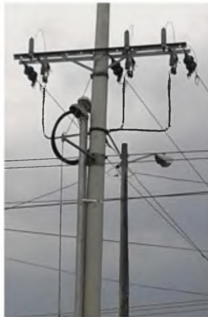
Figura 5.1 Acometida en media tensión Fuente: El autor
