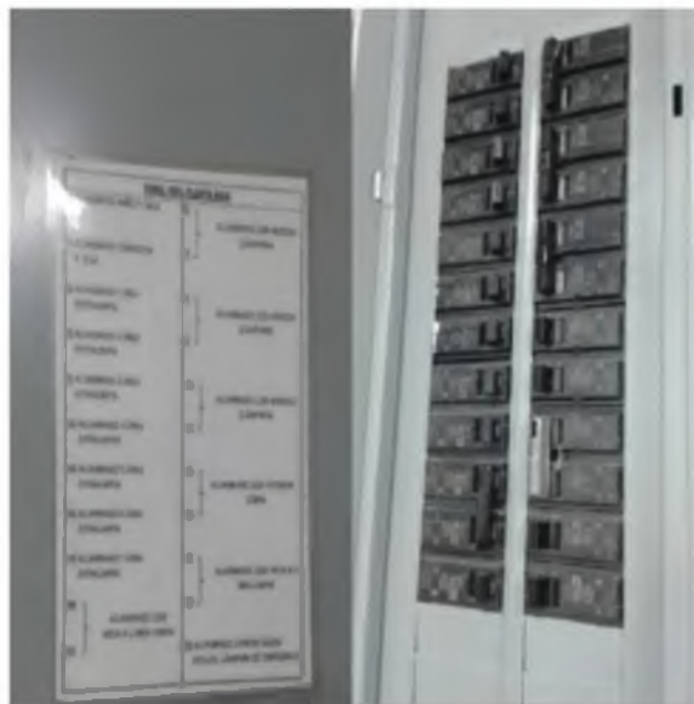
Figura 5.12 Tablero PD2 Fuente: El autor
