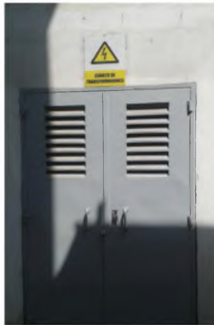
Figura 5.2 Cuarto del transformador Fuente: El autor
