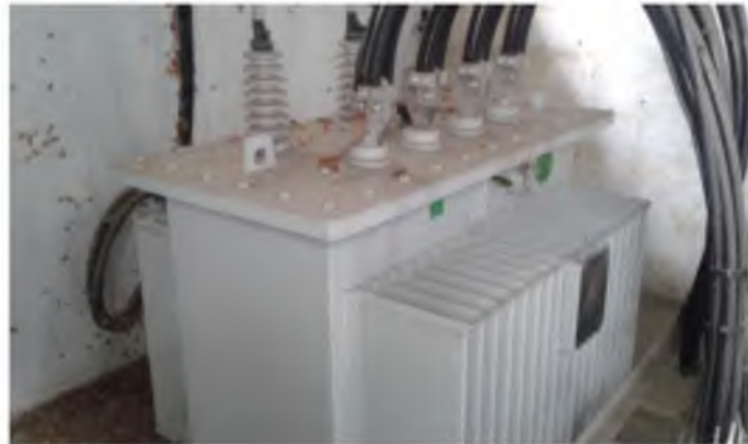
Figura 5.3 Transformador de Factorytech Fuente: El autor
