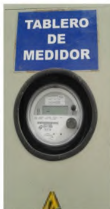
Figura 5.5 Tablero de medidor Fuente: El autor
