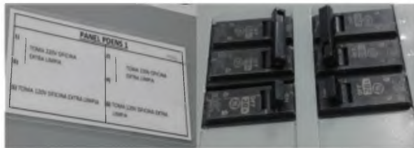
Figura 5.15 Tablero PD5 Fuente: El autor
