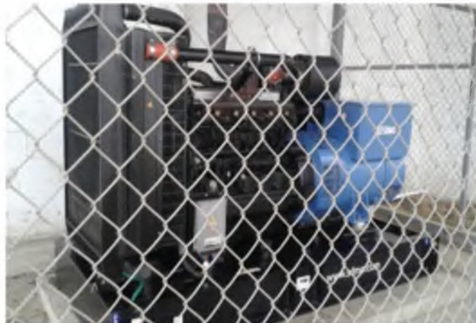
Figura 5.6 Generador Factorytech Fuente: El autor
