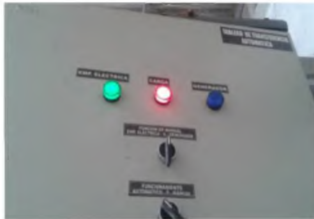
Figura 5.7 Tablero de transferencia automática Fuente: El autor
