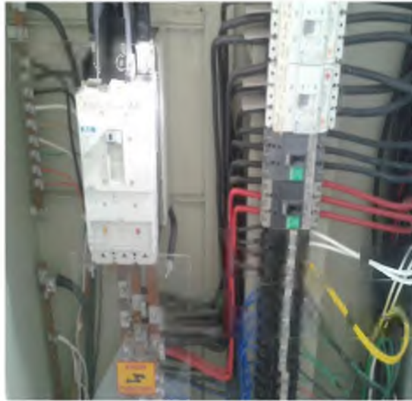
Figura 5.11 Tablero PD1 Fuente: El autor
