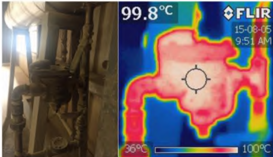
Figura 4-4 Termografía trampa de balde invertido manifold de distribución
