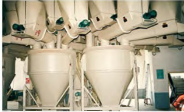
Figura 2-1 Sistema de dosificación de granos
