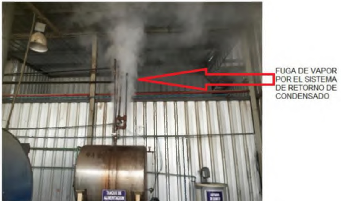
Figura 4-7 Fuga y perdida de vapor por el sistema de retorno de condensado
