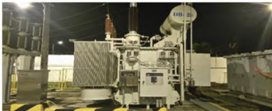
Figura 7.38: Transformador de potencia de 18/24 MVA; 69/13.8 Kv de la subestación Durán-Norte perteneciente a la Unidad de Negocio Guayas-Los Ríos.
