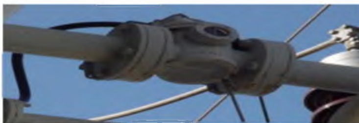
Figura 2.17: Relé Buchholz en transformador con tanque conservador. Fuente: (Flores, 2010)
