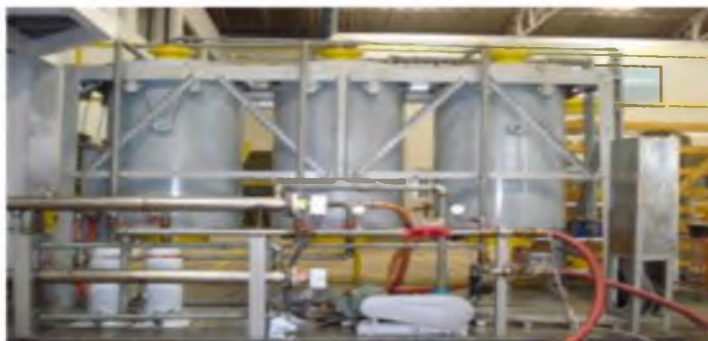
Figura 6.37: Filtrado por gravedad con tres depósitos que contienen tierra Fuller. Fuente: (BriTransformadores S.A., 2012)
