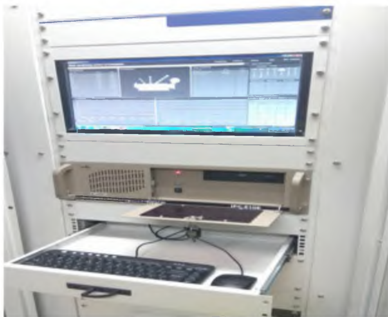
Anexo 1.5 Vista frontal del gabinete de control con los hardware de comunicación y visualización (monitor, teclado y mouse).
