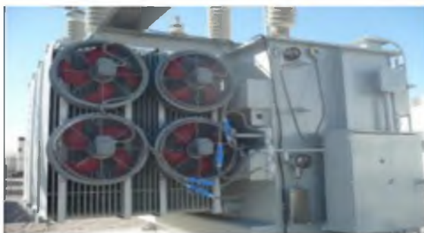
Figura 3.26: Transformador con enfriamiento clase OA/FOA/FOA. Fuente: RVR Transformadores
