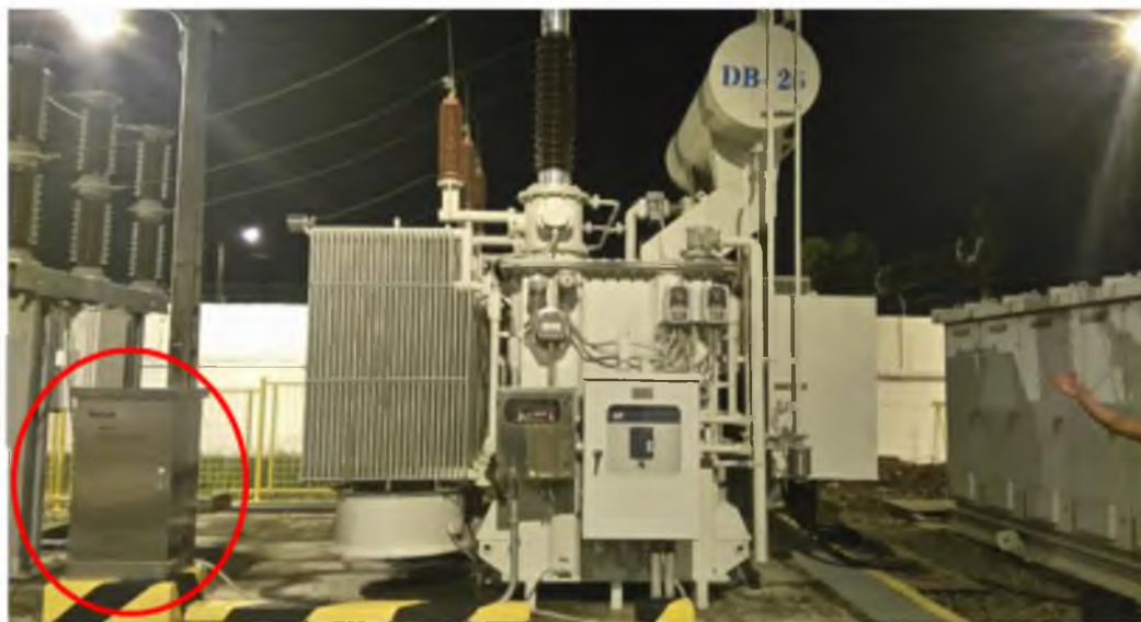
Anexo 1.2 Ubicación del equipo TROM-600 (dentro de la circunferencia) en el patio de la Subestación Durán –Norte junto al transformador de potencia de 18/24 MVA.
