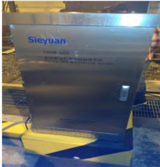
Anexo 1.7 Vista frontal del equipo TROM-600 sobre su base en el patio de la subestación Durán-Norte.
