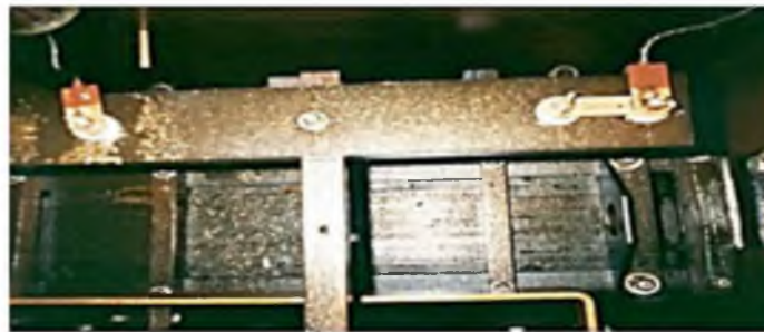
Figura 4.31: Núcleo de un transformador con presencia de lodos. Fuente: (Landy Viscaíno, 2015)
