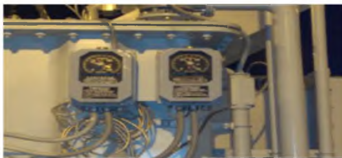
Figura 7.39: Medidores de temperatura instalados en el transformador a monitorear. Fuente: Autor
