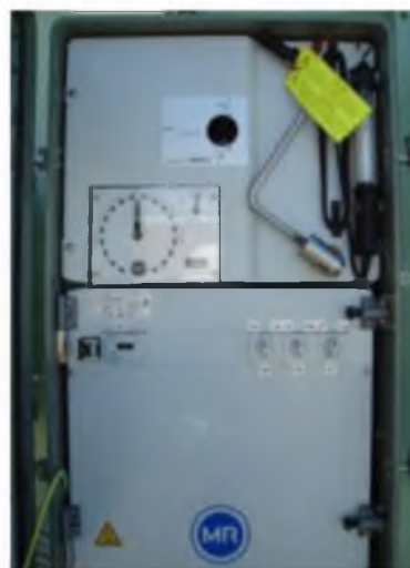
Figura 2.11: Cambiador de TAP en gabinete de MaschinenFabrik Reinhausen (MR). Fuente: Ing. Gabriel Horacio Orellana
