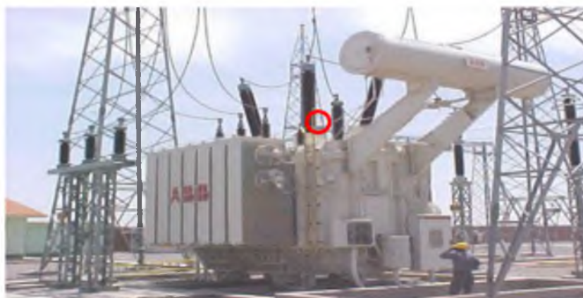
Figura 2.12: Pararrayo en transformador de potencia 245KV ABB.
