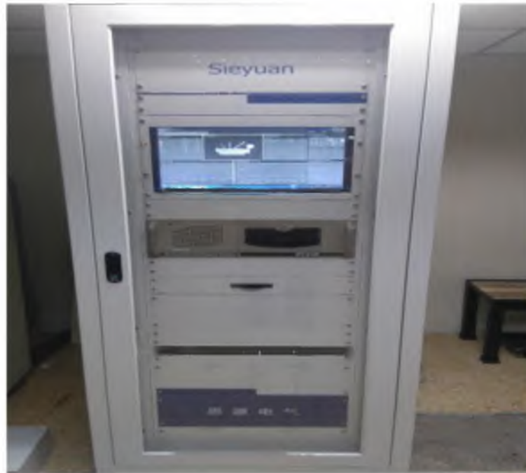
Anexo 1.3 Vista frontal del gabinete de control del TROM-600 en el interior del cuarto de control de la Subestación Durán –Norte..
