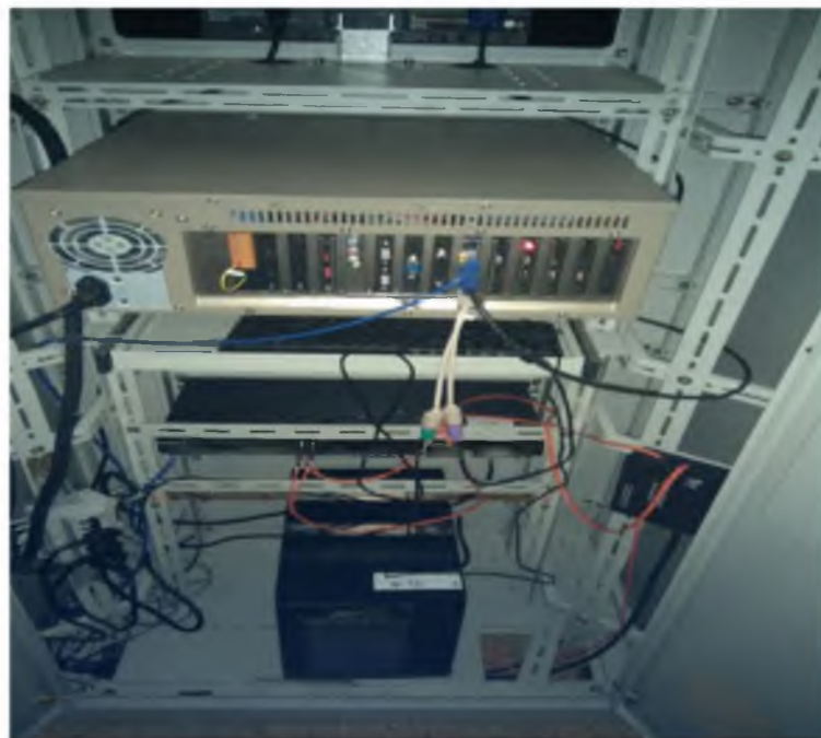
Anexo 1.4 Vista posterior (puerta abierta) del gabinete de control del Sistema de Monitoreo en línea TROM-600.
