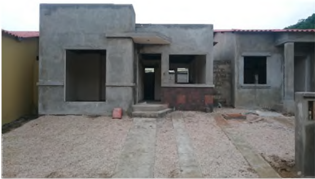
Proceso constructivo de Villa. Modelo FM. Ciudadela La Joya Etapa Corona. Daule-Ecuador
