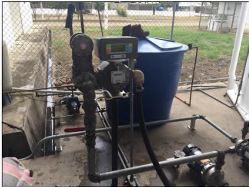
Tanque con bomba de agua
