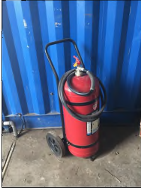
Extintor contra incendios
