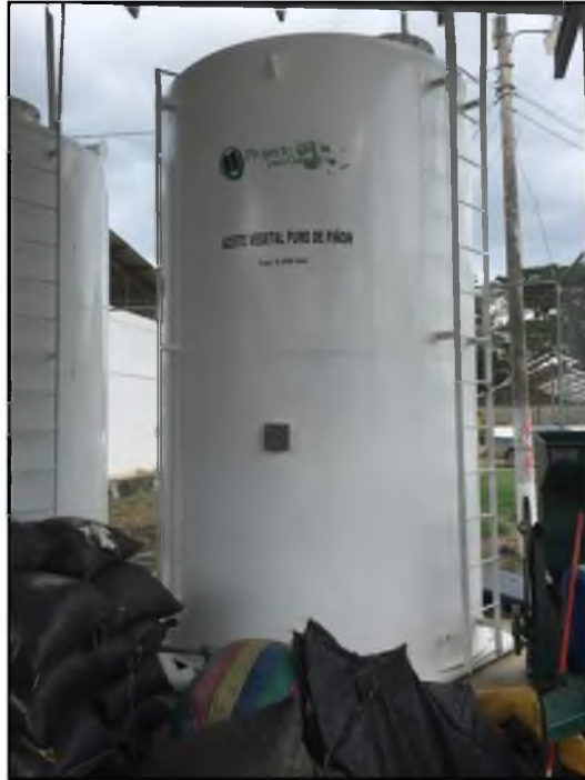
Tanques de Aceite de Piñón
