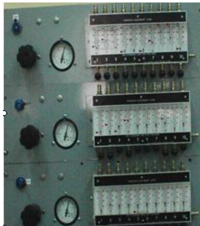
Figura 4. 2: Rotámetro. Fuente: Cortesía ETECSA.
