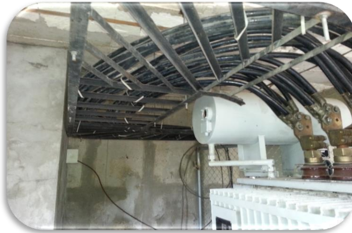
Figura 3. 18 Acometidas que salen del secundario del Transformador y alimenta al Breaker Principal.
