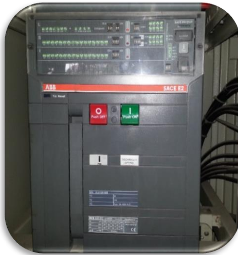
Figura 3. 19 . Breaker principal del tablero de distribución.
