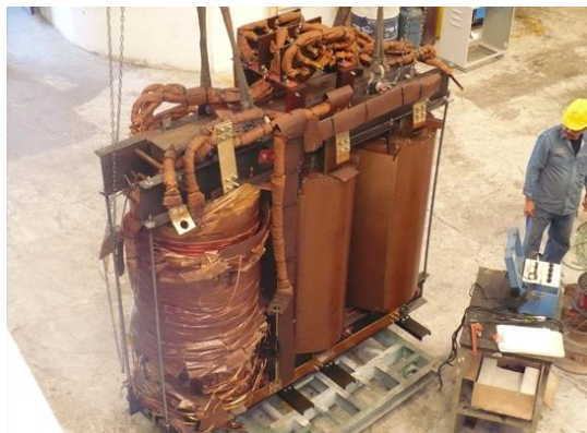
Figura 3.3 Efectos del agua en un transformador de potencia Fuente: http://rvrtransformadores.com/w2/nuestros-servicios/
