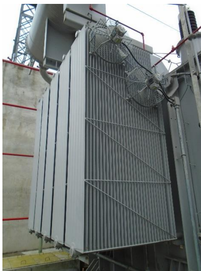
Figura 2.10 Radiadores de placa y ventiladores del sistema de enfriamiento Fuente: Autor
