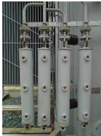
Figura 2.11 Secador de aire de un transformador de potencia Fuente: Autor
