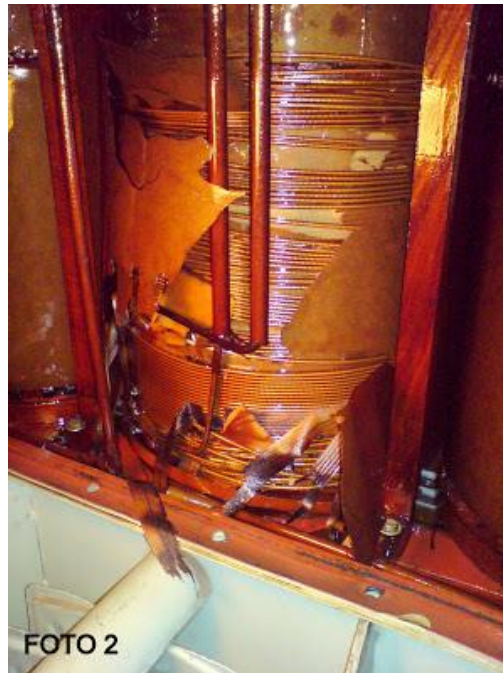
Figura 3.4 Deterioro del aislante solido a causa del sobrecalentamiento. Fuente: http://ingenieriaelectricaexplicada.blogspot.com/2009_11_01_archive.html
