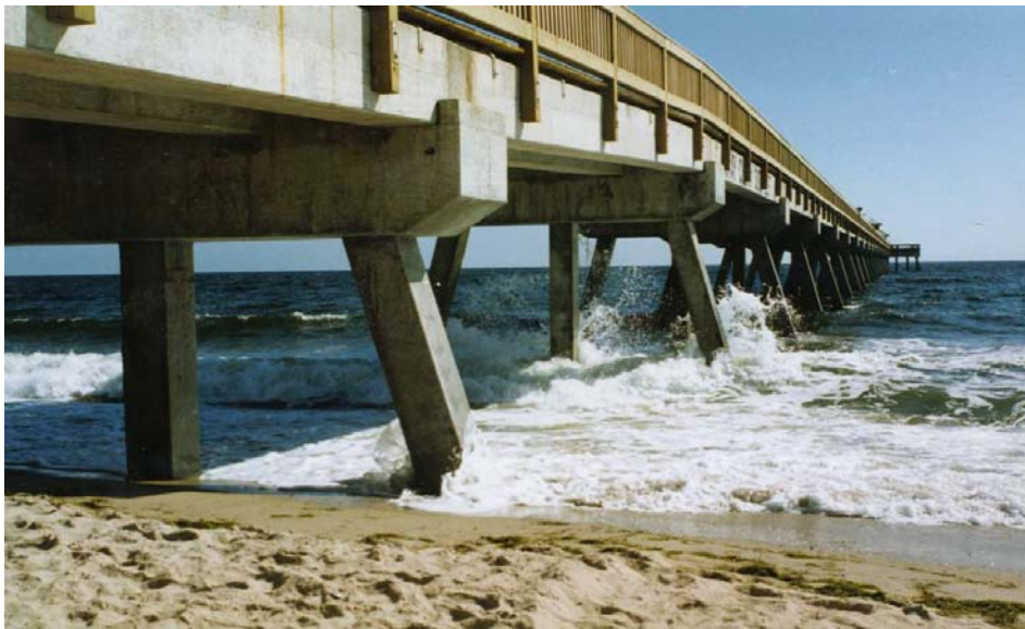
Figura# 6 Deterioro por causas de aguas agresivas (mar)
