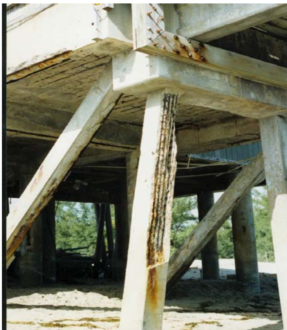
Figura# 7 Columna afectada por causas de aguas agresivas (mar)
