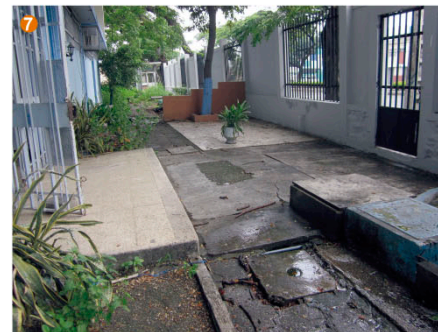
Figura 11: Imagen de instalaciones deficientes. Fuente: Elaboración propia
