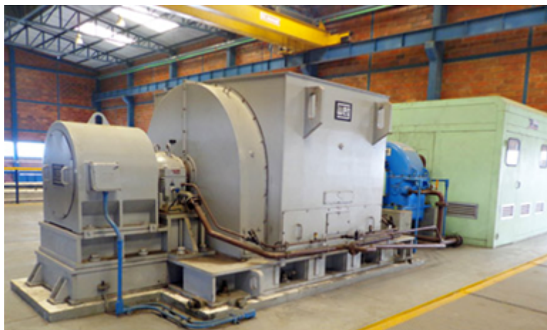
Figura 7. 6 Turbo generador número tres de la planta de cogeneración en el Ingenio San Carlos Fuente: Uni-systems (2010)
