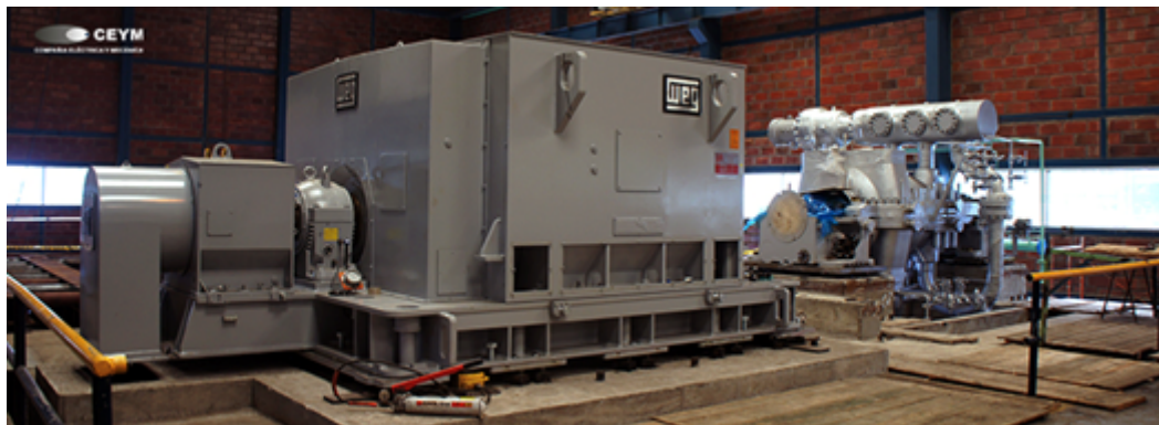
Figura 7. 8 Turbo generador número cinco en la planta de cogeneración del Ingenio San Carlos Fuente: CEYM Compañía eléctrica y mecánica (2015)
