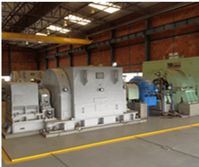
Figura 7. 7 Turbo generador número cuatro de la planta de cogeneración en el Ingenio San Carlos Fuente: Omaconsa (2013)
