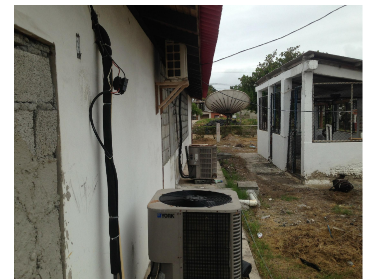
Figura 8. Acondicionadores de aire Fuente: Quimbiulco, 2014
