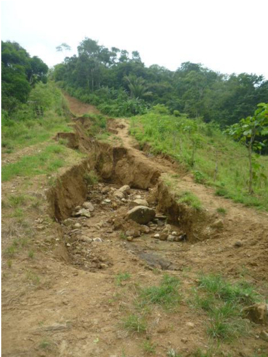
Imagen anexo 1: carretera en mal estado
