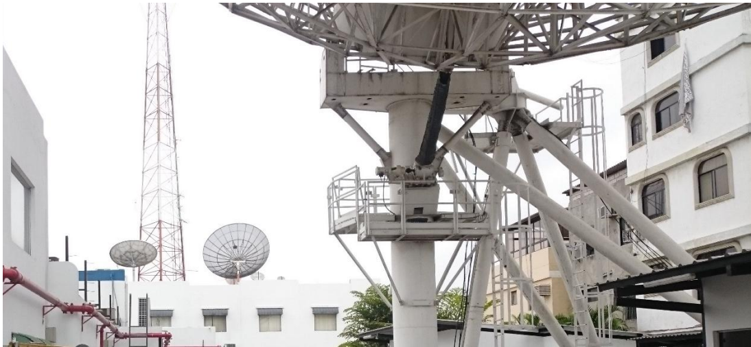
Figura 4.8. Vista Panorámica de las Antenas del Grupo TV Cable Fuente: (Fraga Jiménez, 2015)
