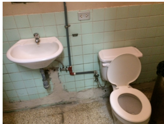
Figura 29: Revestimiento en pared y piso de baños deteriorado por el uso. Fuente: Rosero (2014)
