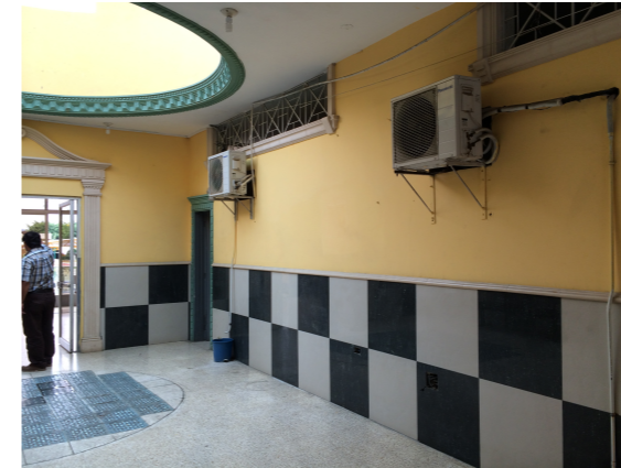
Figura 3: Unidades exteriores de Split en pasillo principal de planta alta. Fuente: Rosero (2014)
