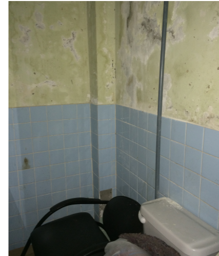
Figura 24: Presencia de moho en paredes de baños. Fuente: Rosero (2014)
