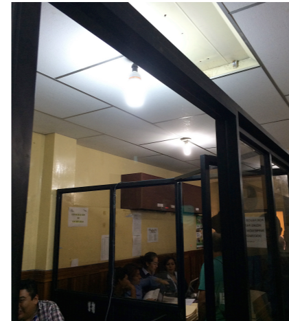
Figura 26: Sistema de iluminación artificial deficiente. Fuente: Rosero (2014)
