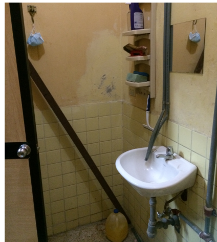
Figura 28: Instalaciones de AAPP provisionales Fuente: Rosero (2014)
