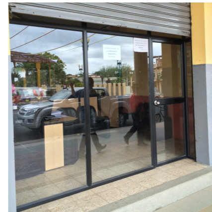
Figura 12: Presencia de desniveles en ingreso a oficinas de planta baja. Fuente: Rosero (2014)
