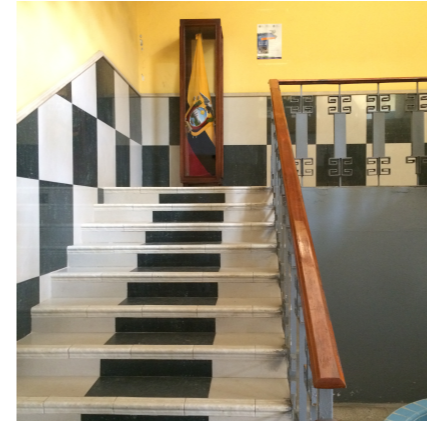
Figura 11: Escaleras existentes. Fuente: Rosero (2014)
