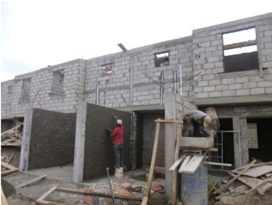
Figura 16: Personal de Obra sin equipo de Seguridad Industrial Fuente: Astudillo (2015)
