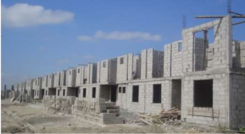
Figura 17: Villas Paralizadas con material en intemperie Fuente: Promotora Inmobiliaria Urbanis S.A., (2013)
