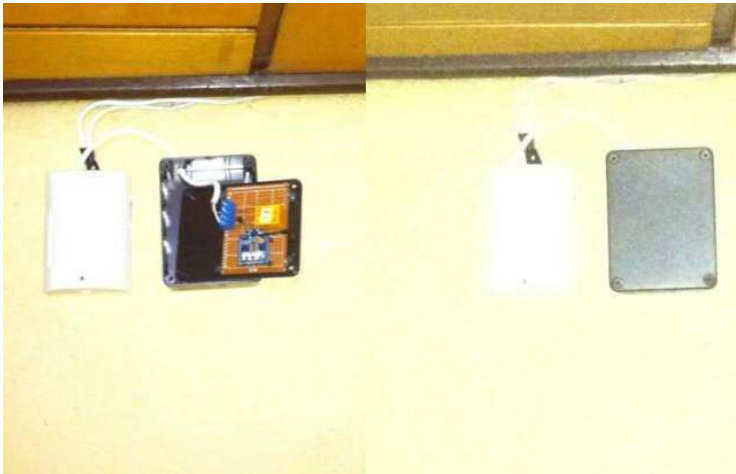
Figura 39 Instalacion del Sensor de Movimientos
