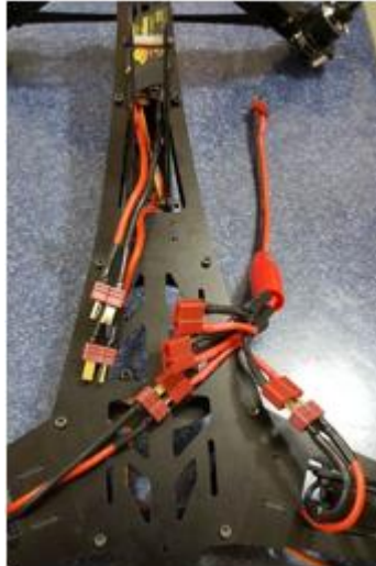
Figura 3. 15: Conexión de cables de energía con el cable de distribución. Fuente: Autores.
