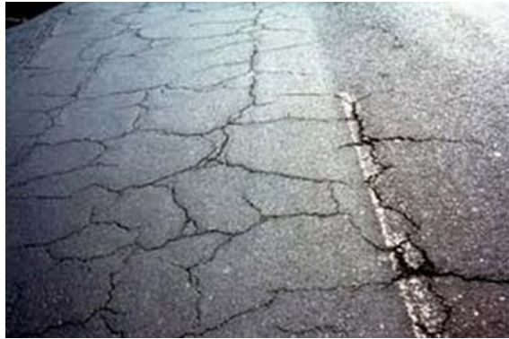
Figura 4.2 Ilustración de una falla severa por agrietamiento por fatiga
