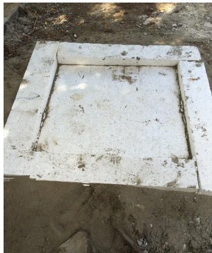
Figura 16. Masa de hormigón totalmente cubierta de poliestireno. (Fuente: Autor)
