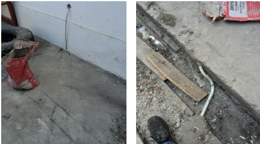
Figura 11. Recorrido de cables desde el sitio de fundición hasta el interior del CEINVES (Fuente: Autor)
