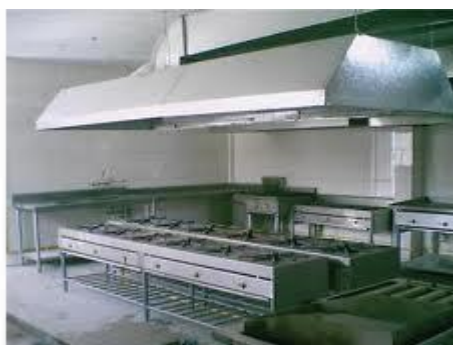
Imagen # 44: Cocina Industrial
