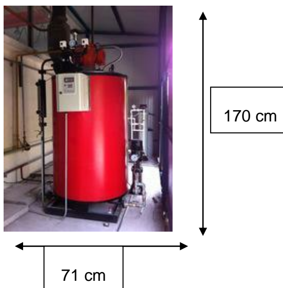
Figura 41. : Caldera Alemana Marca Bulter a Gas Industrial Elaboración: Helder Vieira Da Costa
