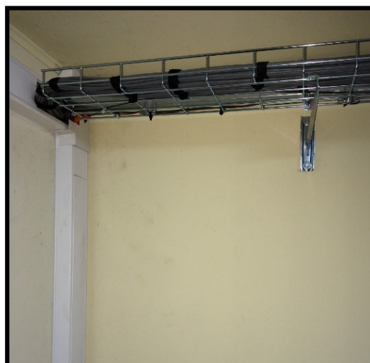
Figura 4. 16: Canastilla o Escalerilla Tramo 1
