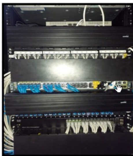
Figura 4. 21: Patch Panel para un Sistema de Cableado
