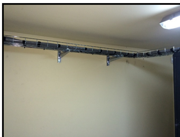
Figura 4. 17: Canastilla / Escalerilla Tramo 2 de forma horizontal
