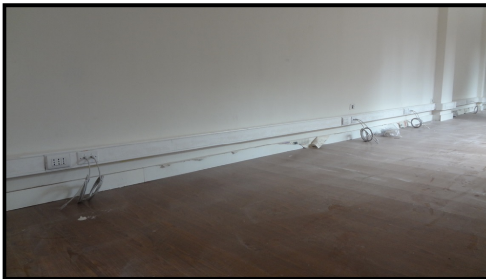
Figura 4. 12: Cableado por canaleta con su separadora
