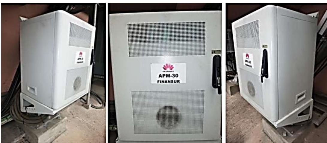
Figura 3.18: Vista frontal de los nuevos equipos Fuente: Autor
