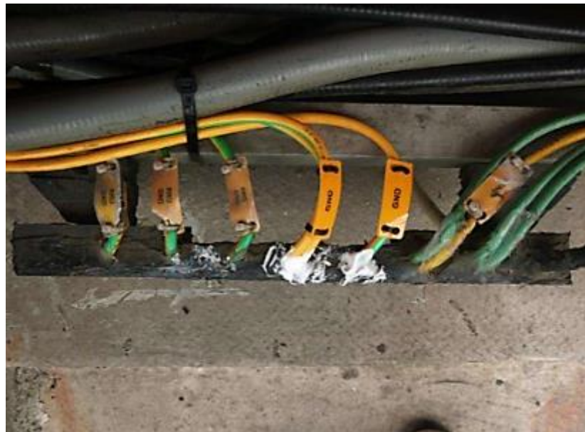
Figura 3.21: Etiquetado de cables de tierra de los nuevos equipos Fuente: Autor
