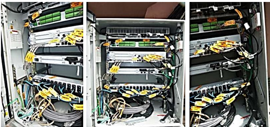
Figura 3.19: Etiquetado de cables de datos de los nuevos equipos Fuente: Autor
