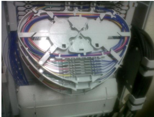
Figura 3 Cajas Ópticas 24 Puertos
