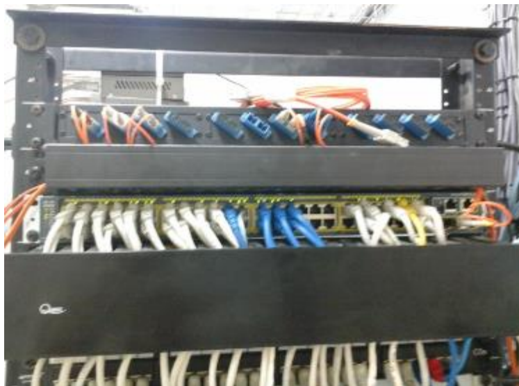
Figura 3. 9: Switch principal del rack de la FETD.
