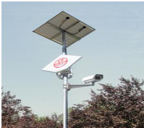
Figura 12 Aplicación de paneles solares
