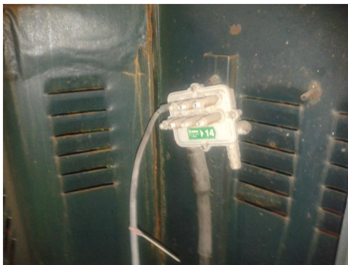
Figura 3.5 Armario abierto de TVCABLE
