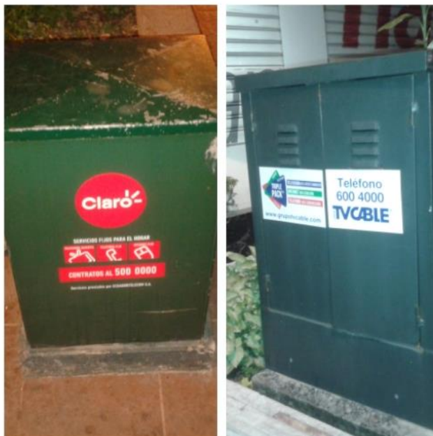
Figura 3.4 Armarios de TVCABLE y CLARO
