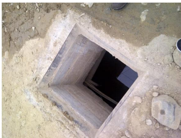
Figura 3.3 Vista superior de cámara de registro
