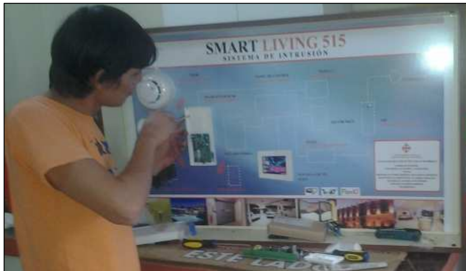
Figura 4.2 Instalación del Transceptor
