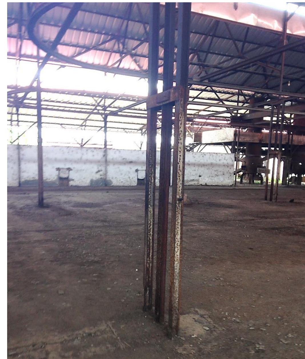
Figura 60. Vista de la estructura oxidada. Autor: Ramón (2014)
