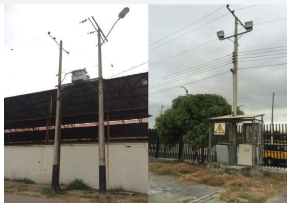
Figura 22. Transformadores eléctricos. Autor: Ramón, (2014)
