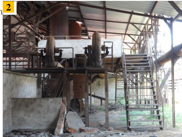
Figura 62. Tubos de la caldera. Autor: Ramón (2014)
