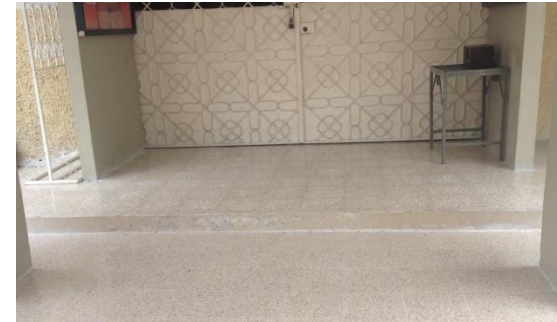
Figura 11: Desnivel de acceso a la iglesia.
