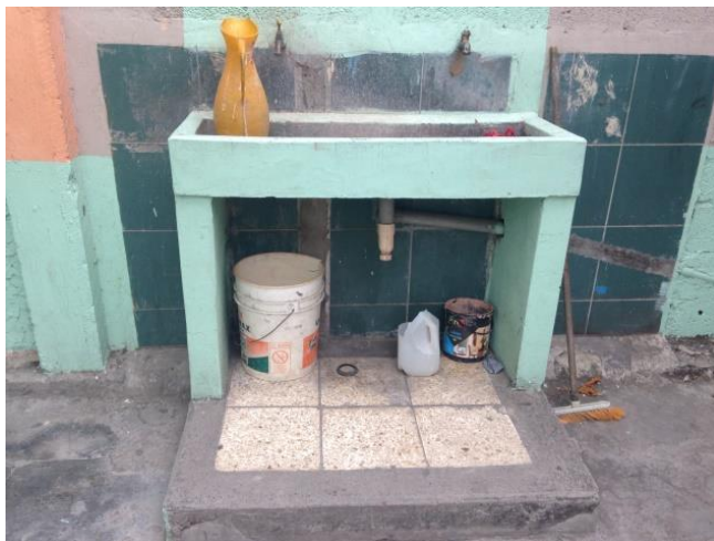
Figura 22: Lavadero en la parte exterior de los baños. Fuente: Feijoó, (2014)
