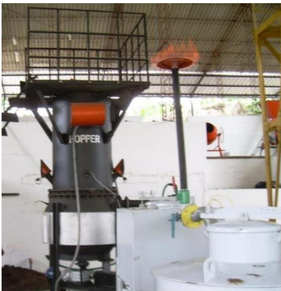
Figura 2.6 Planta de gasificación por pirolisis – la concordia (estación INIAP) Fuente: Energía (2014).
