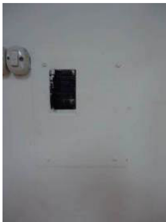
Figura 3.22 Panel Breaker 5 Elaborado: Autor
