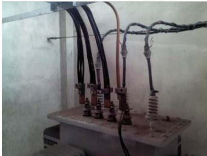
Figura 3.6 Conexión de media tensión y baja tensión en bushing del transformador. Elaborado: Autor
