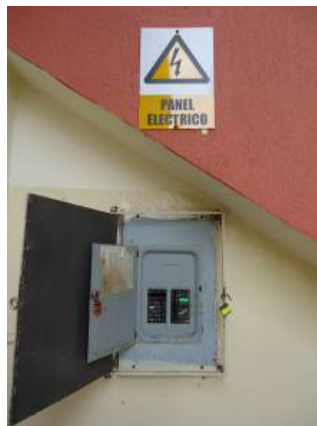
Figura 3.27 Panel Breaker 10 Elaborado: Autor
