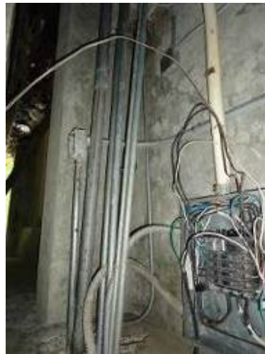
Figura 3.30 Panel Breaker 12 Elaborado: Autor
