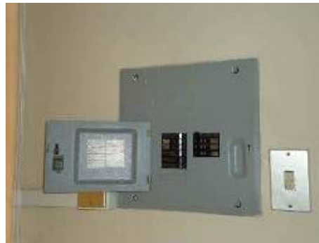
Figura 3.17 Panel Breaker 2 Elaborado: Autor
