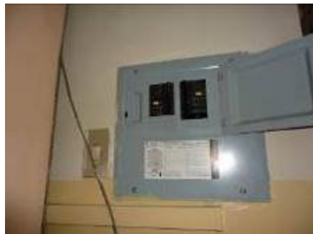
Figura 3.19 Panel Breaker 3 Elaborado: Autor
