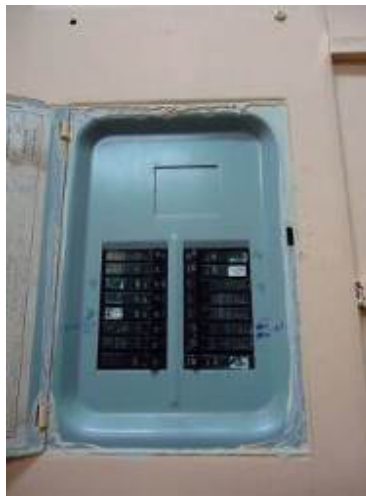
Figura 3.11 Panel Breaker 1 Elaborado: Autor
