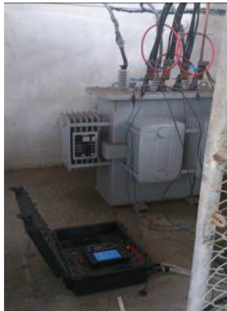
Figura 5.2 Conexiones en baja tensión con el equipo de Medición ION7650 Elaborado: Autor
