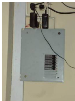
Figura 3.16 Panel Breaker 1 Elaborado: Autor
