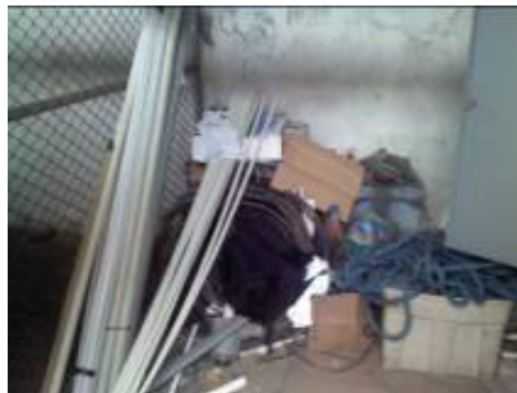
Figura 3.7 Condiciones actuales del cuarto de transformador Elaborado: Autor
