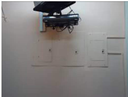
Figura 3.10 Ubicación de paneles Panel Breaker 1, 2 y 3 Elaborado: Autor
