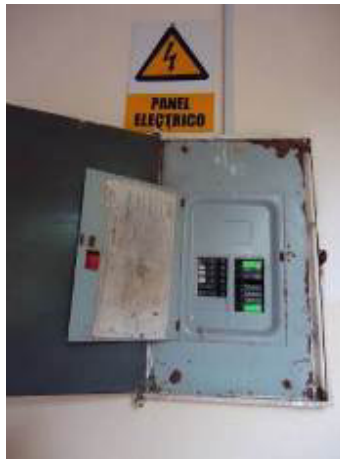
Figura 3.24 Panel Breaker 7 Elaborado: Autor
