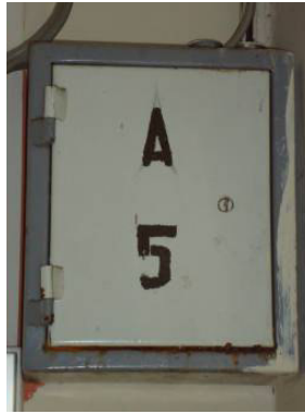
Figura 3.15 Panel Breaker 5 Elaborado: Autor
