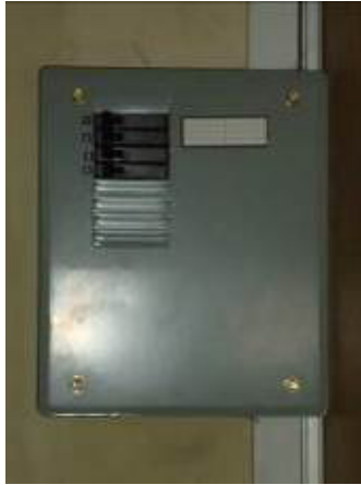
Figura 3.14 Panel Breaker 4 Elaborado: Autor
