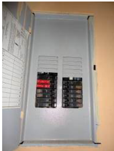
Figura 3.13 Panel Breaker 3 Elaborado: Autor
