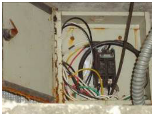
Figura 3.31 Panel Breaker 13 Elaborado: Autor
