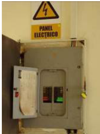
Figura 3.28 Panel Breaker 11 Elaborado: Autor
