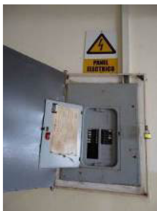
Figura 3.23 Panel Breaker 6 Elaborado: Autor
