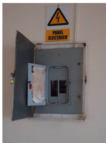
Figura 3.26 Panel Breaker 9 Elaborado: Autor
