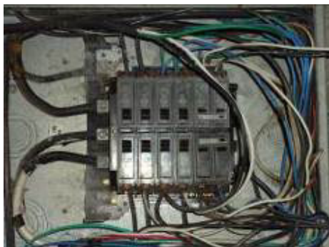
Figura 3.32 Panel Breaker 14 Elaborado: Autor
