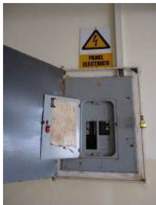
Figura 3.20 Panel Breaker 4 Elaborado: Autor
