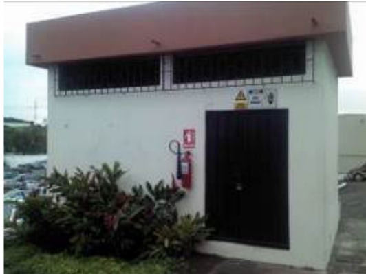
Figura 3.4 Entrada Principal del cuarto del transformador.
