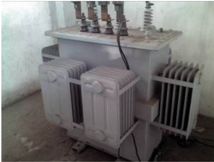
Figura 3.5 Transformador de la Facultad de Filosofía, Letras y Ciencias de la Educación. Elaborado: Autor
