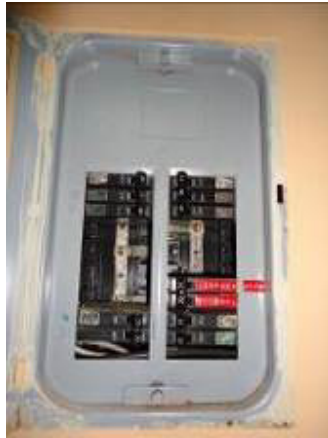
Figura 3.12 Panel Breaker 2 Elaborado: Autor
