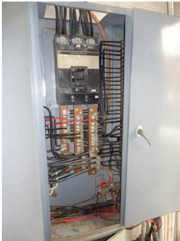
Figura 3.8 Panel Principal de Distribución (PPD) Elaborado: Autor
