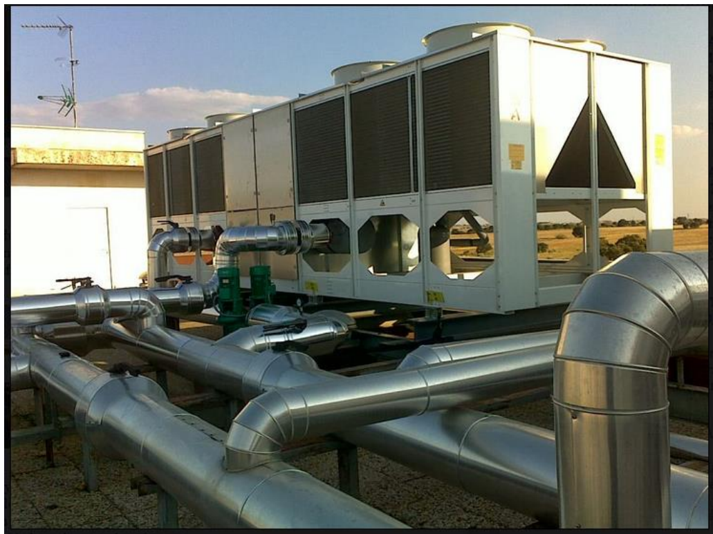
Ilustración 2: Sistemas de climatización
