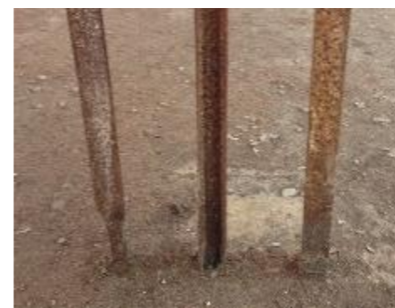
Figura 81. Estructura de columnas deteriorada.
