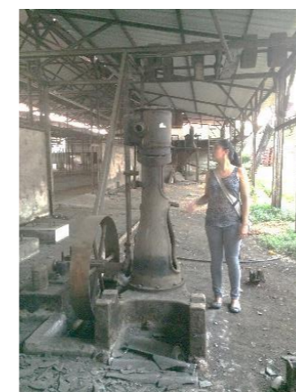
Figura 70. 5 – Maquinaria en espacio de circulación. Fuente: Farías, Ramón, Torres, Zúñiga (2014)
