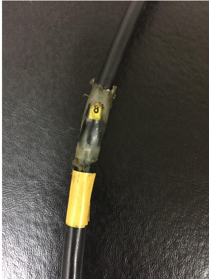
Figura 3.14 Implementación artesanal de sensor en cable de medición Autor: Omar Tello y Alfredo Villares
