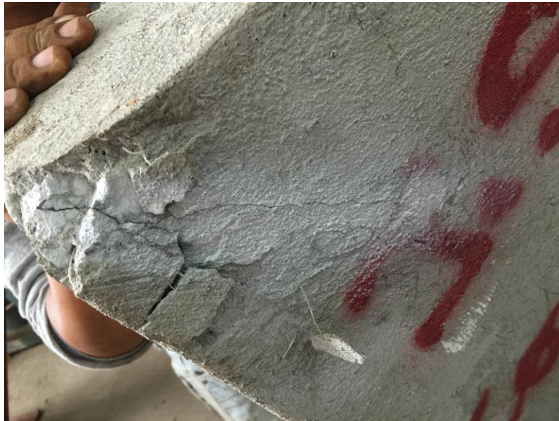
Imagen 12. Resultado de Prueba (pequeñas fisuras)
