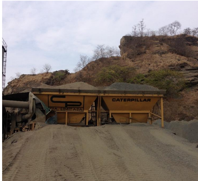
Grafico 2-2 Tolvas que contienen agregados en una planta de mezcla asfáltica (Cantera Duran)
