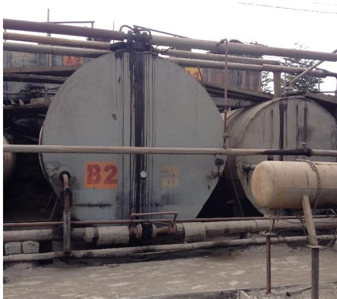
Grafico 2-1 Tanque de almacenamiento asfalto AC-20 en la cantera Duran
