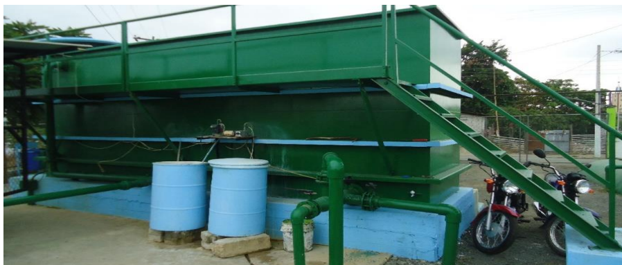
Figura 3. 5 Planta potabilizadora de agua UPA, sector San Javier [Fotografía de Yomaira Caicedo]. (Cantón Santa Lucía. 2014).
