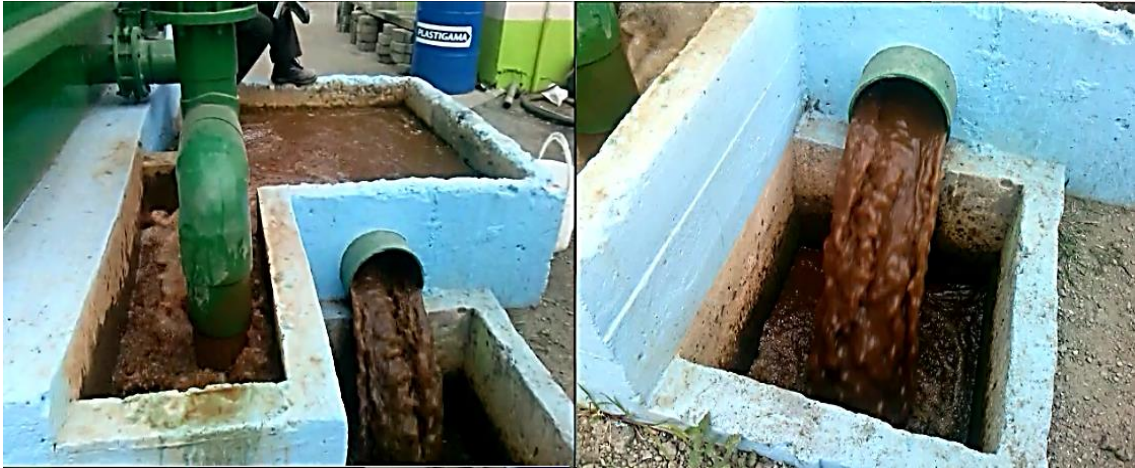
Figura 3. 8 Descarga de lodos Planta UPA, Sector San Javier
