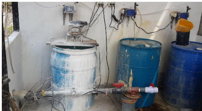
Figura 3. 25 Tanques contenedores de químicos [Fotografía de Yomaira Caicedo]. (Cantón Colimes. 2014).
