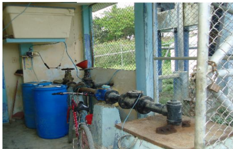
Figura 3. 17 Tanque para cloración
