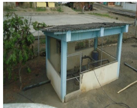
3. 20 Caseta de bombas
