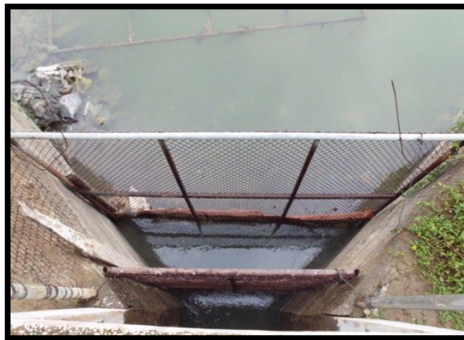
Foto 2.1 Rejilla usada en la bocatoma
