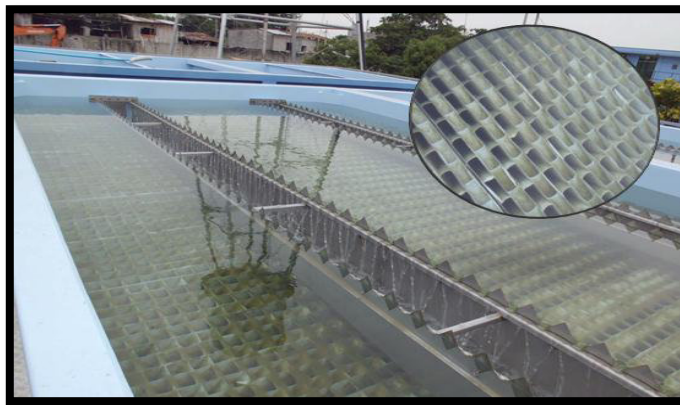
Foto 2.15 Sedimentadores y Módulos
