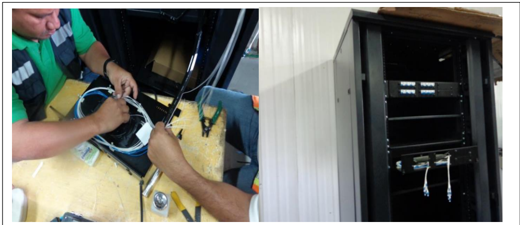
Figura 2.34. Armado y arreglo final de los cables de FO dentro del ODF, vista final
