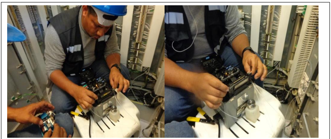
Figura 2.25. Fusión de la FO con los pigtailes y colocación del tubillo termo-retráctil
