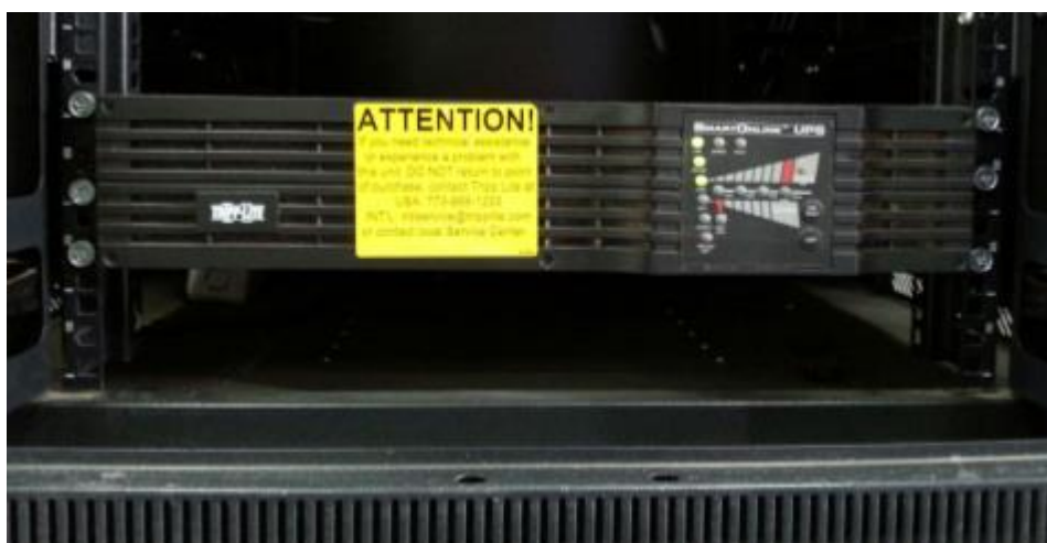
Figura 2.37. UPS de 1500 KVA, 1200 W. Tipo raqueable
