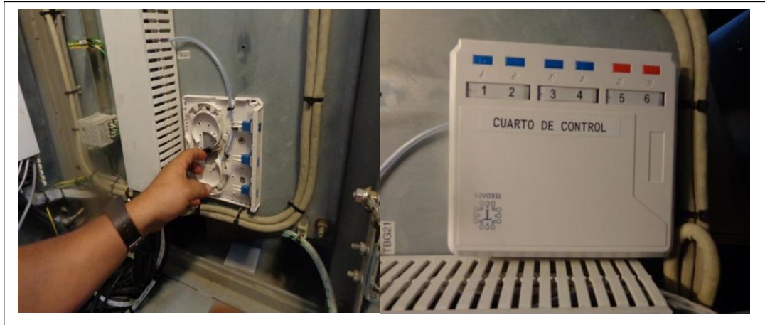
Figura 2.26. Peinado y orden final de la FO, colocación de tapa y etiquetado del mini ODF
