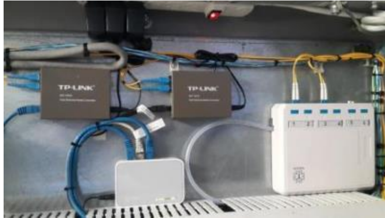
Figura 2.29. Algunos de los equipos instalados para la red LAN
