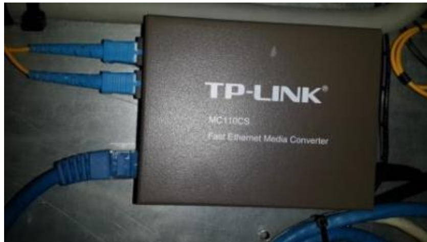
Figura 2.28. Media converter, instalado en cada máquina
