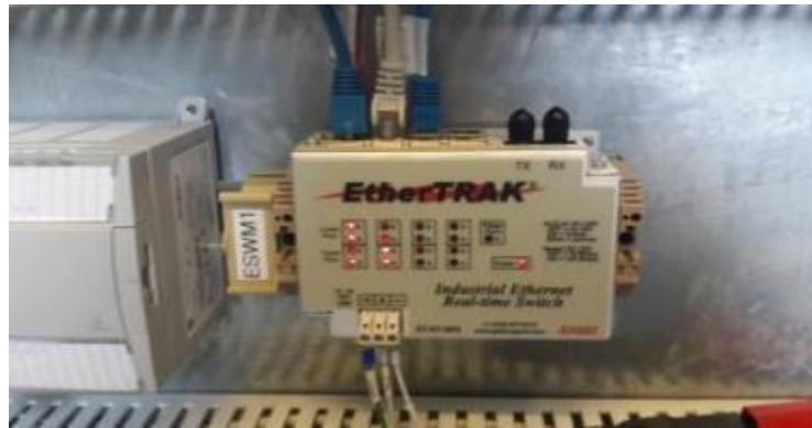
Figura 2.30. Switch de tipo industrial, propio de la Unidad
