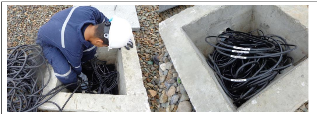
Figura 2.20. Ingreso de la FO por las cajas de paso y etiquetado del cable
