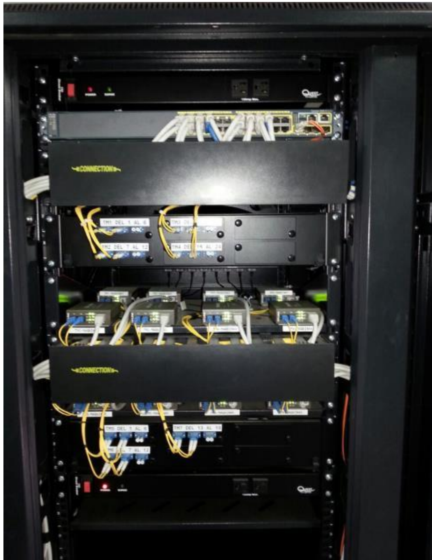
Figura 2.41. Rack armado e interconectado todos sus elementos
