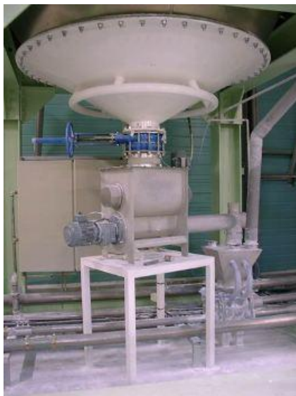
Figura 12 Ejemplo de tolva para el llenado o vaciado de silos
