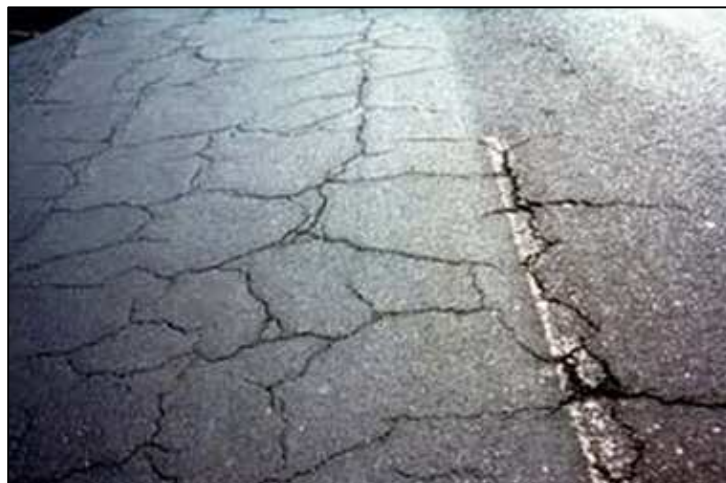
Figura 5.2 Desempeño del pavimento (agrietamiento)
